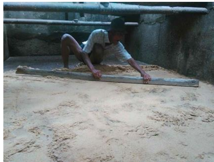
ろ過池内での細砂の削り取り
