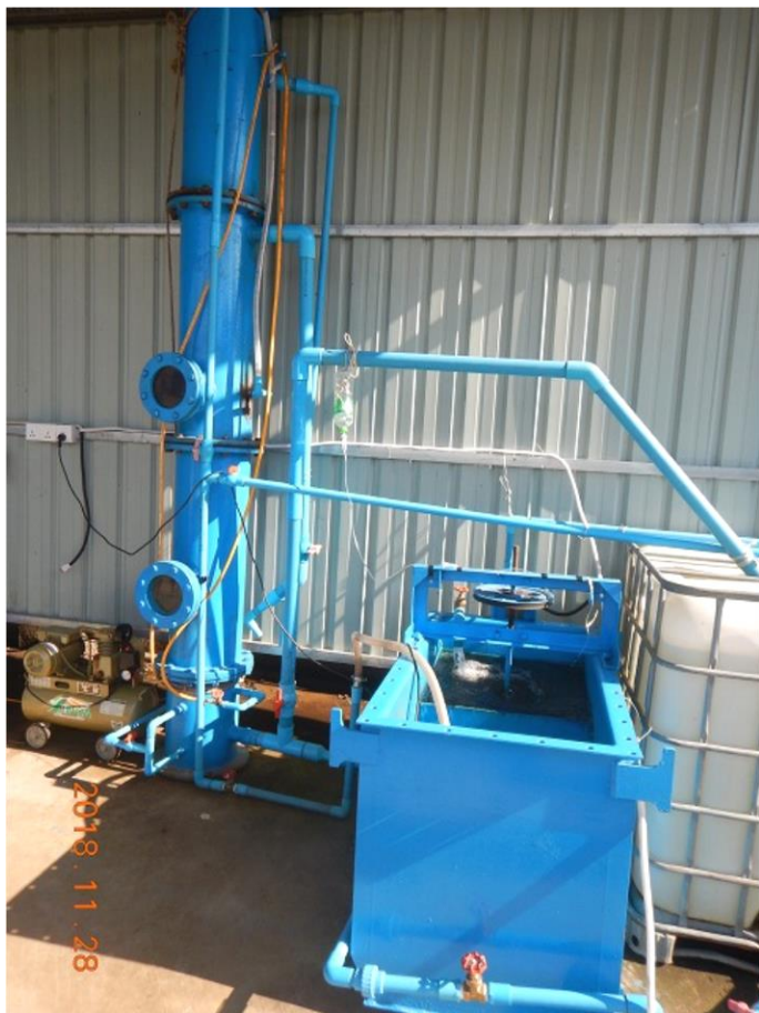
直接ろ過装置と急速攪拌槽
