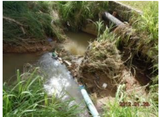
写2 水路等の横断箇所が発生した気泡等
