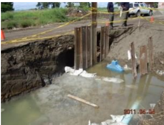
写3 地下水が水道管内に侵入し汚染が
