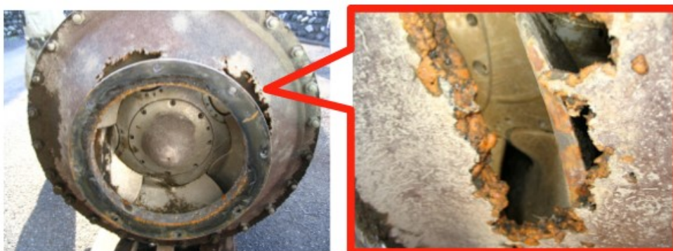
事例1 キャビテーションによる壊食（ポンプケーシングに穴）
