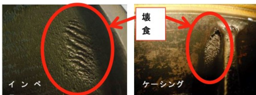
事例2 キャビテーションによる壊食
