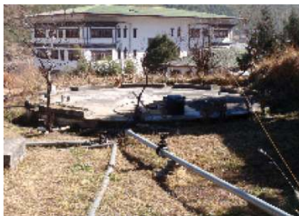
所々に配水タンクがある
