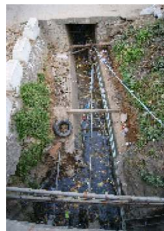
配水管、給水管、電線管が入り混じっている。ゴミの投棄もあり雨季には配管、ゴミにより至る所で氾濫する。
