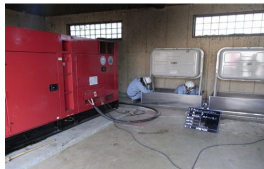
自家発電設備が設置され、給水を開始した 陸前高田市の竹駒水源(5月10日)
