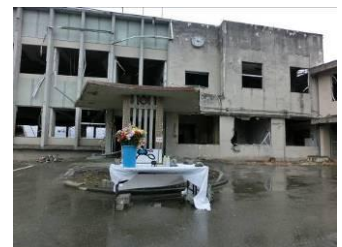
旧町役場、被災のシンボルとして残すかどうか検討中
