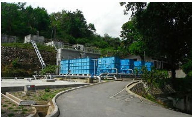
ベモス浄水場(浄水量2000m 3 /日)
