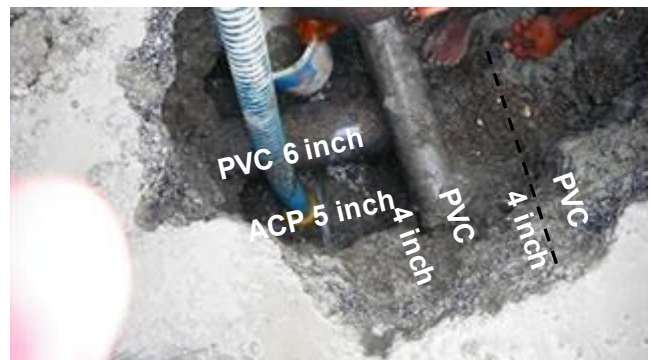
錯綜管路 (ACP 漏水修理時撮影)
