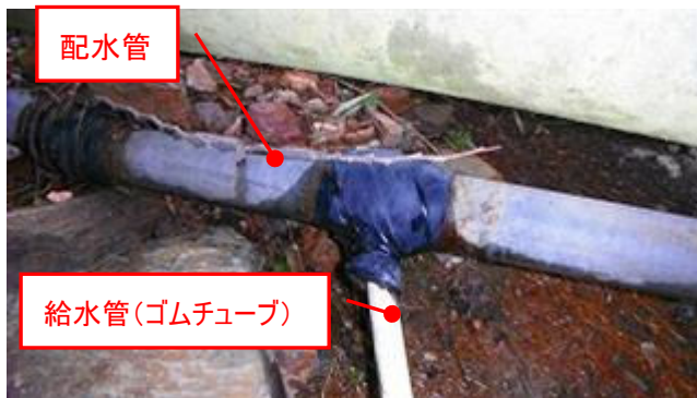
違法接続の給水管
