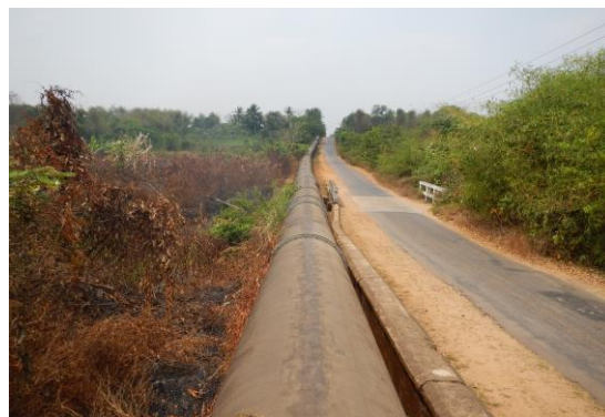
写真-5 地上に68km 伸びる送水管
