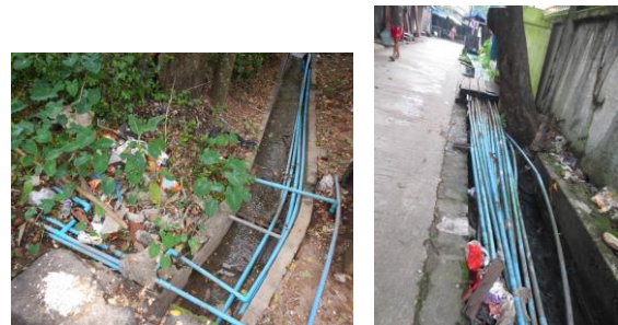
写真-1 タコ足のように地上に伸びる給水管
