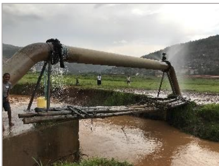
市内最大の送水管からの漏水
